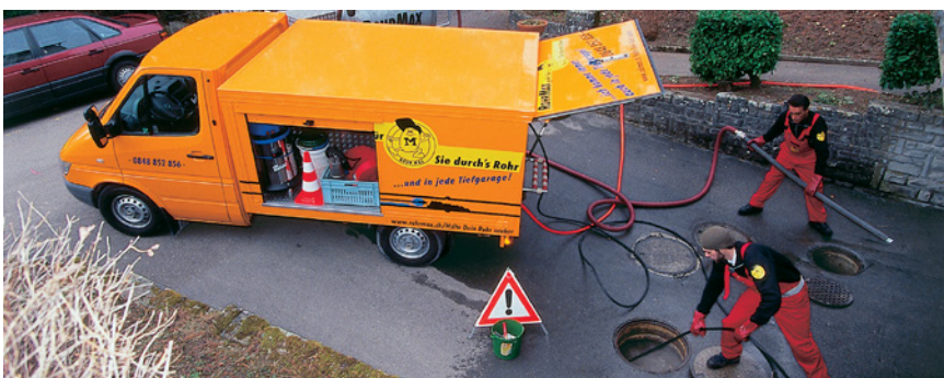
Das Datenerfassungssystem der RohrMax-Flotte wurde auf den neusten Stand gebracht.
